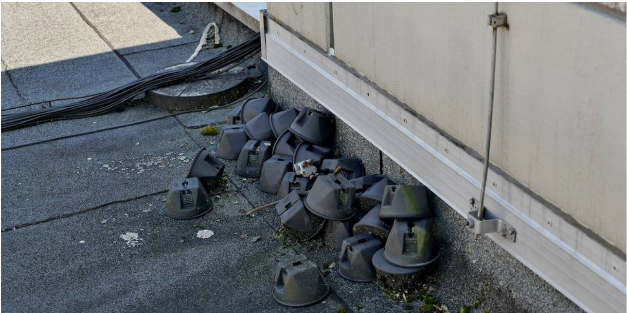
Abbildung 37: nicht mehr montierte Blitzschutzkomponenten auf dem Dach
