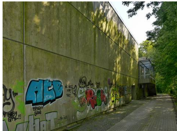
Abbildung 27: Veralgte Westfassade der Sporthalle
