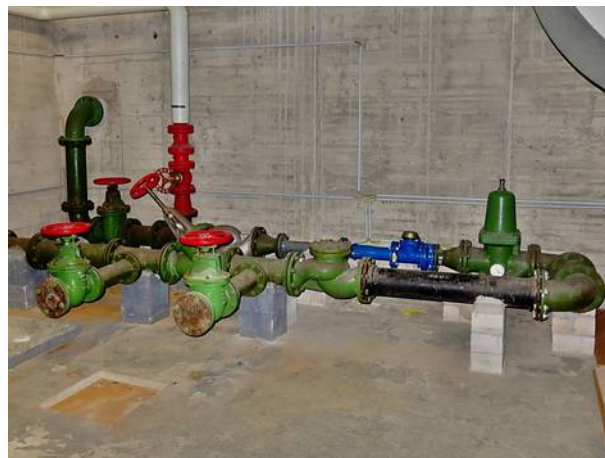
Abbildung 25: Trinkwasserhausanschluss mit nasser Feuerlöschleitung (rote Armatur)
