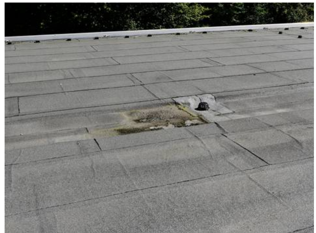
Abbildung 22: Faltenbildung in der Bitumenbahn, Dach Ostseite Bauteil H
