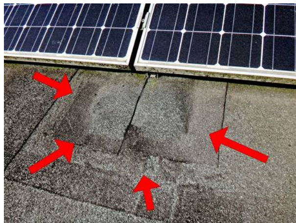
Abbildung 13: Blasenbildung in der bituminösen Abdichtung
