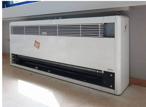
Abbildung 7: Umluftinduktionsgerät im Bauteil S
