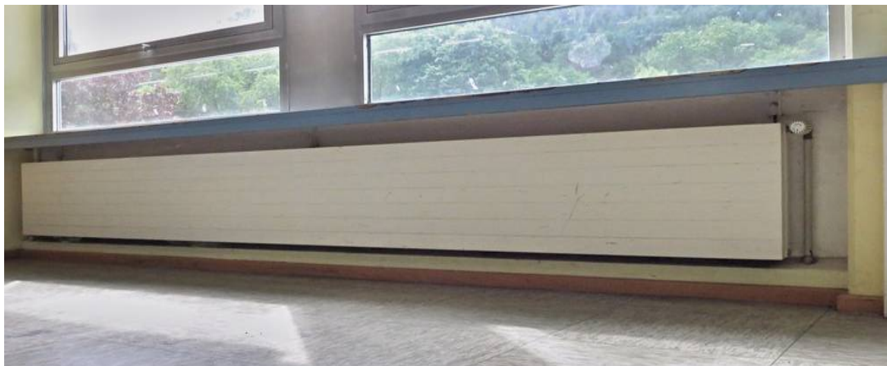
Abbildung 15: Heizkörper in Klasse Bauteil N
