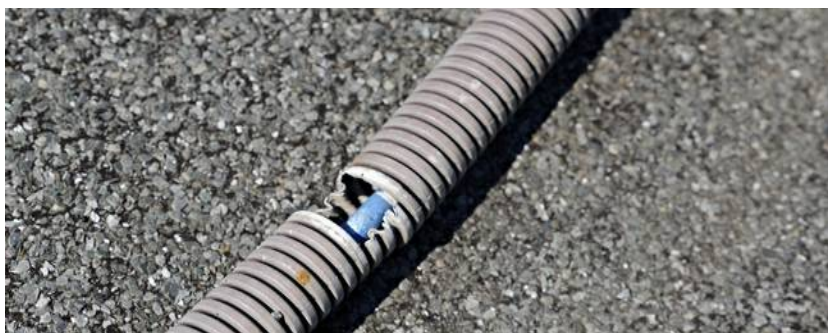
Abbildung 36: defektes Kabelschutzrohr für DC-Kabel
