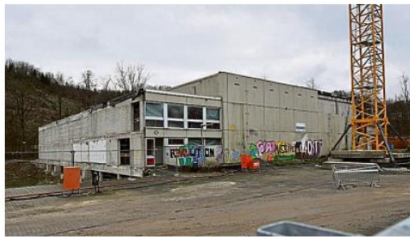
Bauverzögerungen gibt es an der Gesamtschule.
